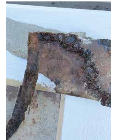
Bilderrätsel: Defektes Dach oder moderne Kunst?
