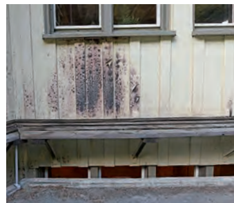
Spuren der versuchten Brandstiftung
